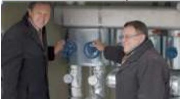
Das neue Nahwärmenetz in Benk (Lkr BT) spart 300 Tonnen CO 2 im Jahr.
